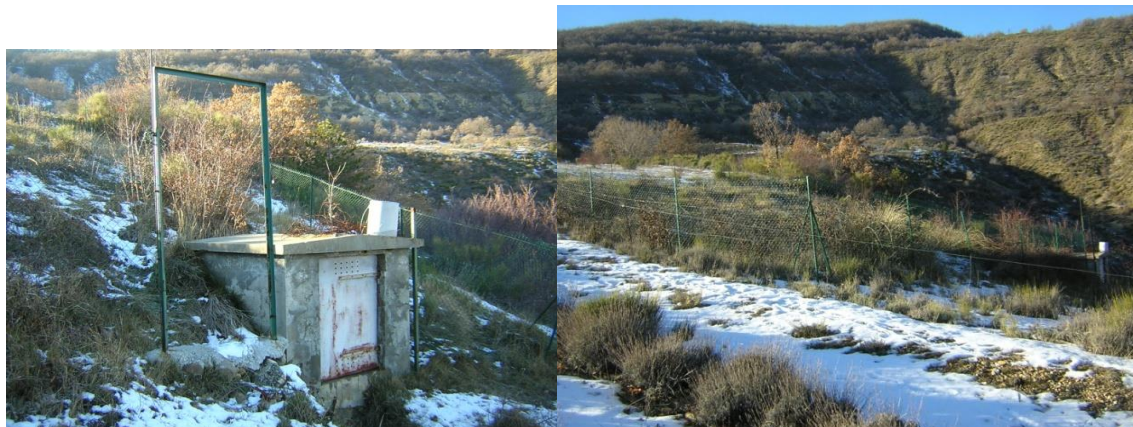
Photo 6 et 6 bis : périmètre et chambre de captage
