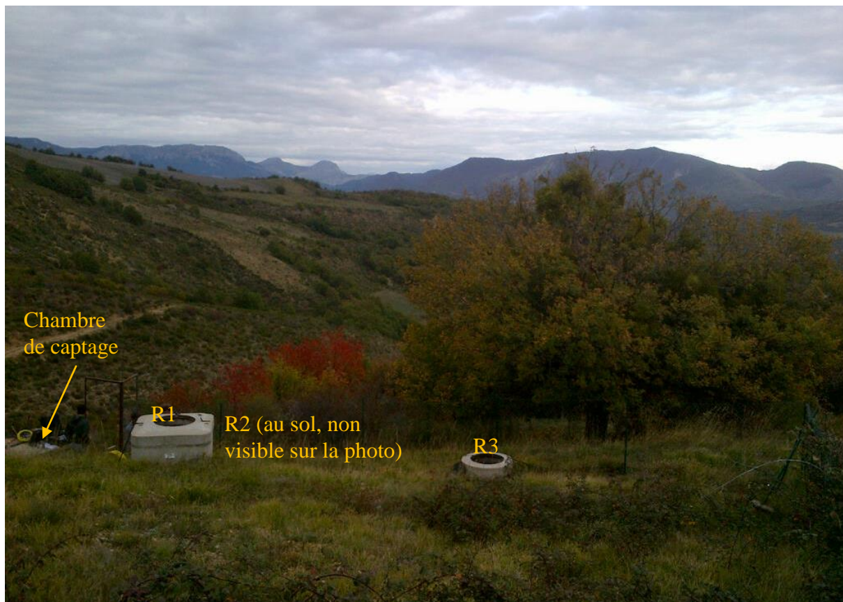
Photo 5 : chambre de captage et regards sur la galerie drainante
