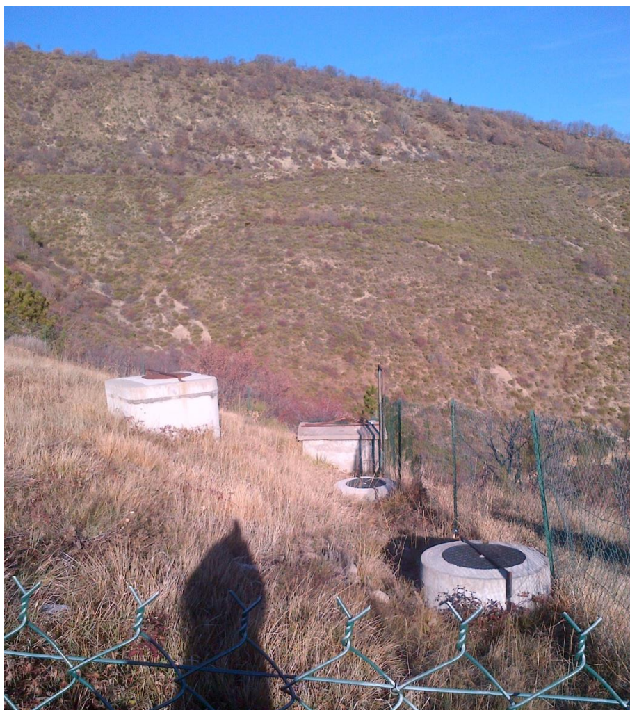
photo 7 : trois regards et chambre de captage, périmètre clôt.
